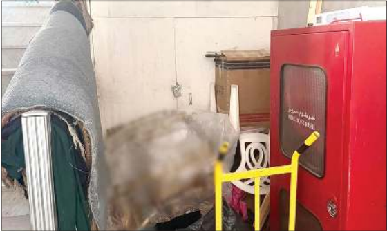
معدات متكسة تعوق الوصول إلى وسائل مكافحة الحريق
