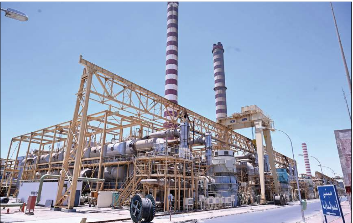
محطة الدوحة الشرقية للقوى الكهربائية وتقطير المياه
