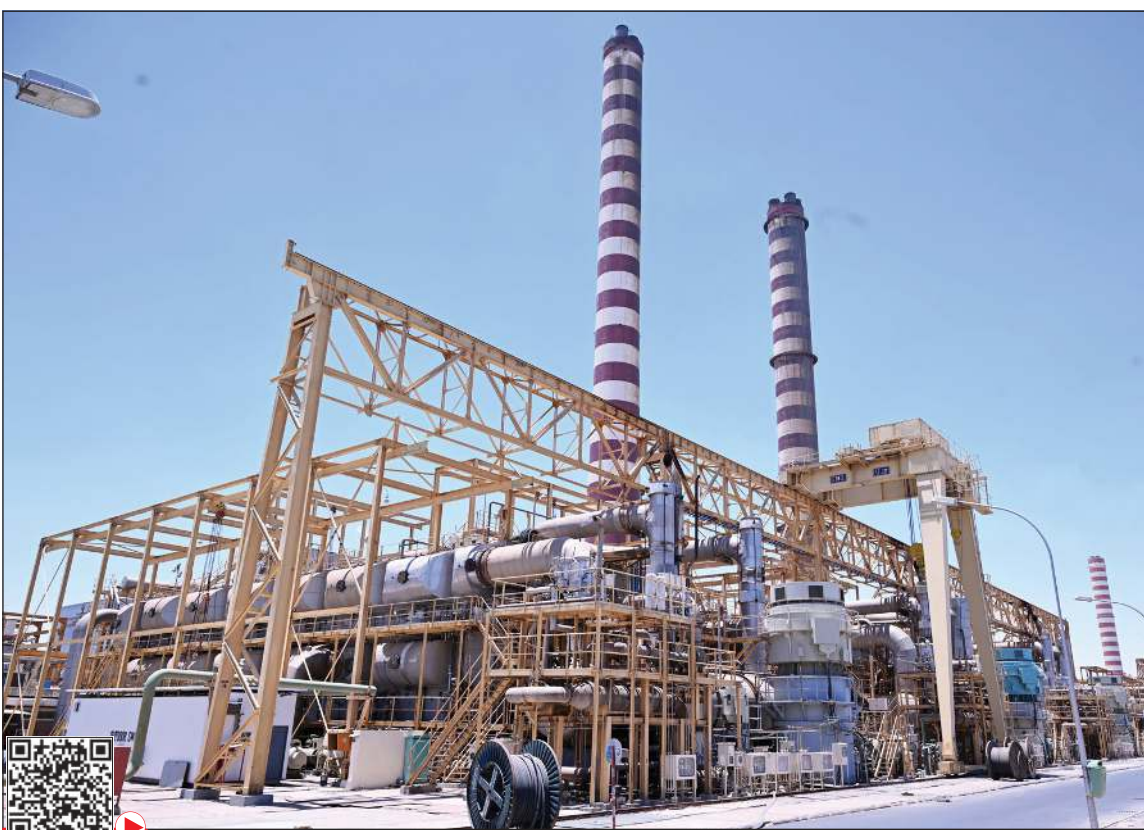
محطة الدوحة الشرقية للقوى الكهربائية وتقطير المياه
