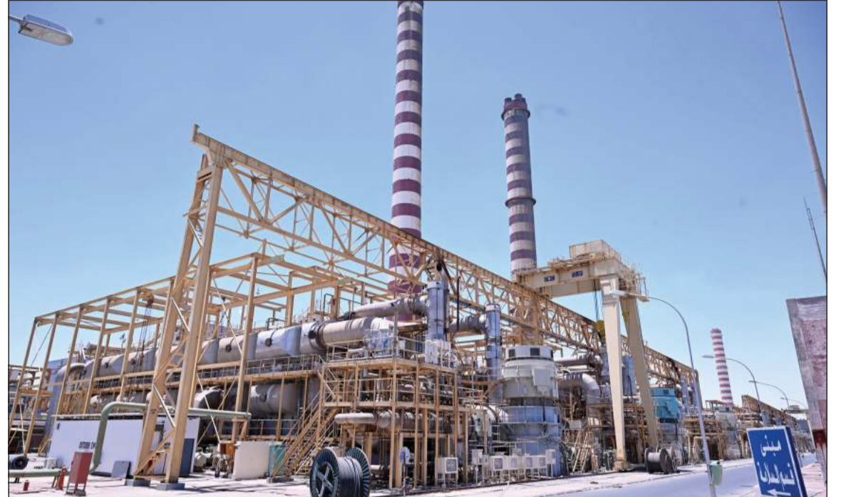
محطة الدوحة الشرقية للقوى الكهربائية وتقطير المياه
