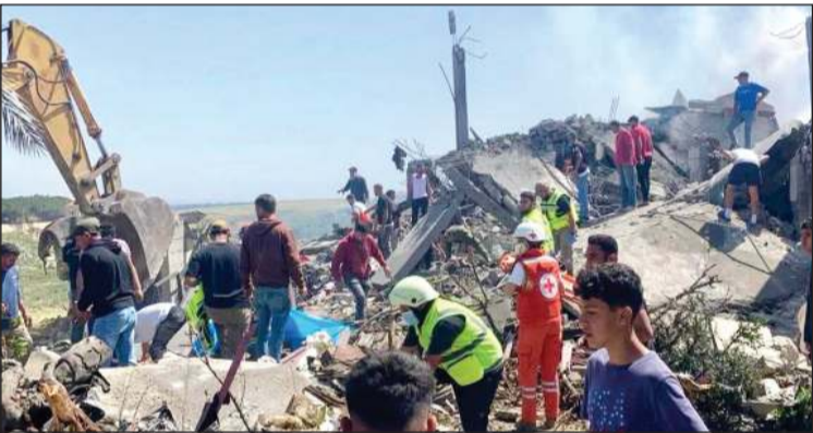
إفغان ضحايا تحت ركام مبنى كان يؤوي 3 عائلات نازحة استهدفتها غارة إسرائيلية في السكسكية جنوب لبنان
