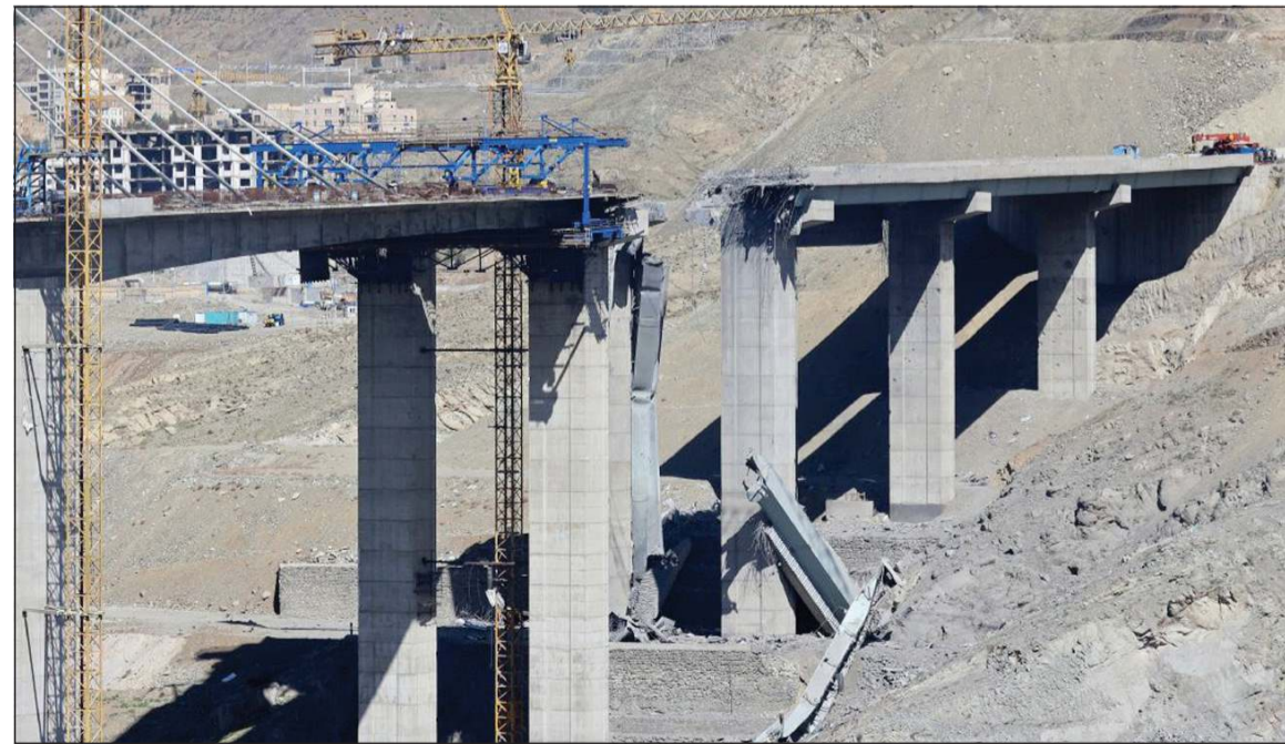
آثار الدمار الذي خلفه قصف الجسر «بي 1» أكبر جسور إيران في كرج جنوب غرب طهران (أ.ف.ب)
