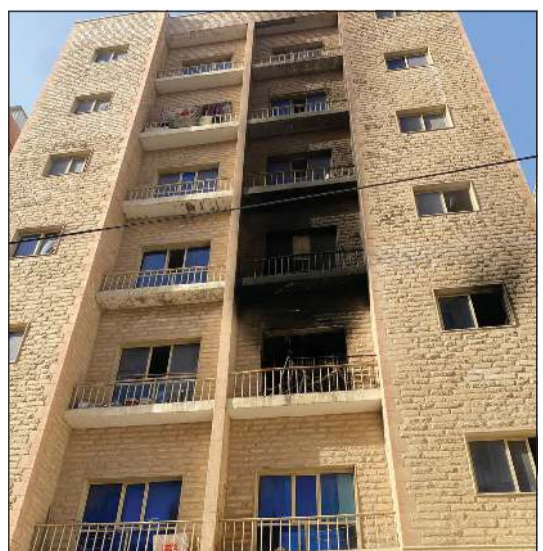
حريق الشقة وقد تسبب في تلفيات بواجهة البناية
