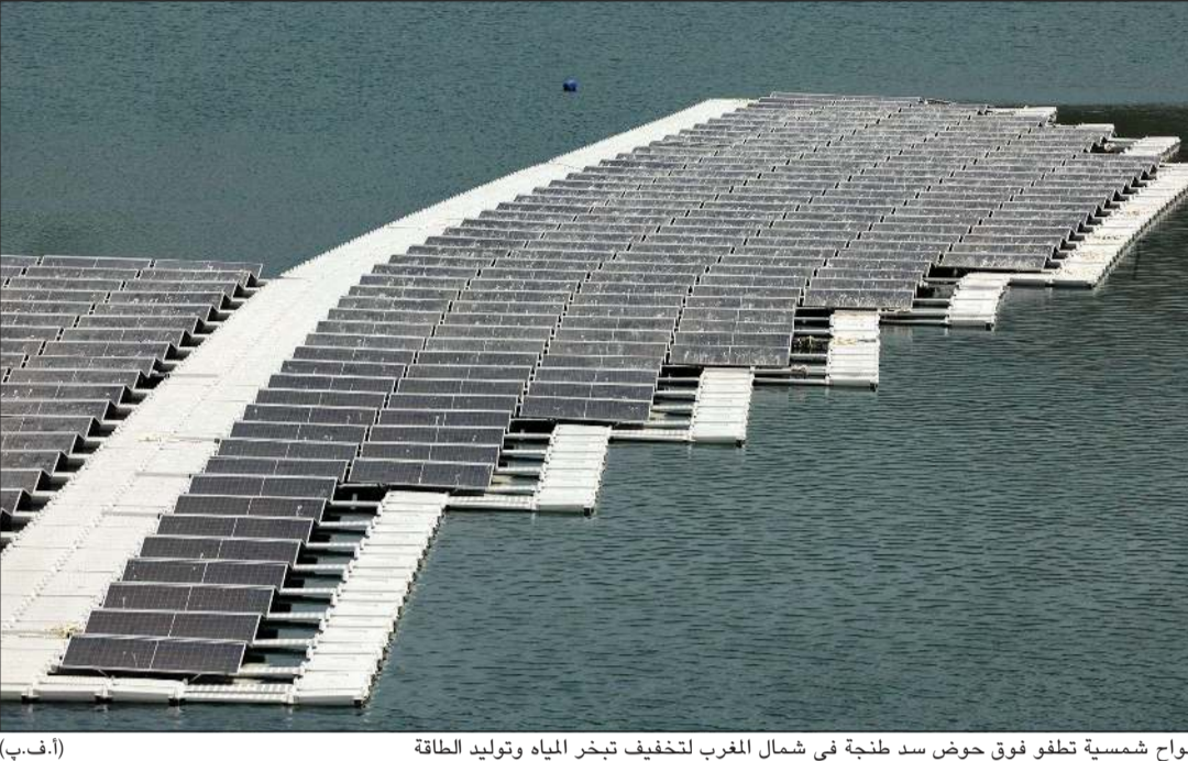
ألواح شمسية تطفو فوق حوض سد طنجة في شمال المغرب لتخفيف تبخر المياه وتوليد الطاقة (أ.ف.ب.)
