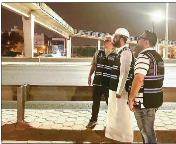
م. خالد العصيمي وفريق هيئة الطرق يتابعون إزالة الجزء المتضرر من الجسر
