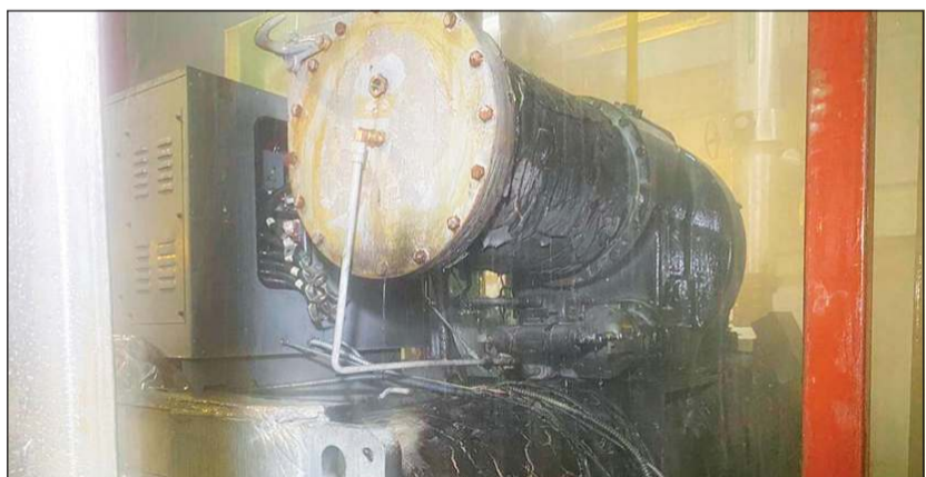
آثار الحريق على مكائن غرفة التحكم
