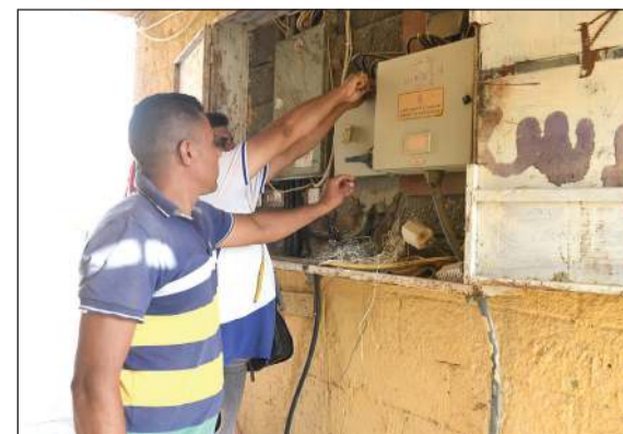
رصد تعديات على الشبكة الكهربائية
