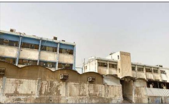
مبنى المدرسة يبدو متهاكاً
