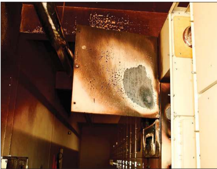
آثار الحريق داخل المحول
