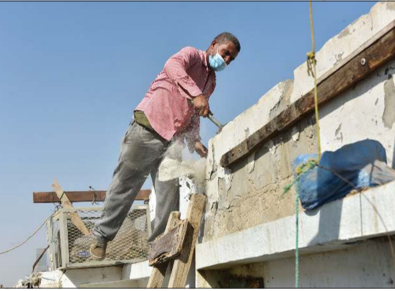
أعمال هدم مخالفة في المنطقة
