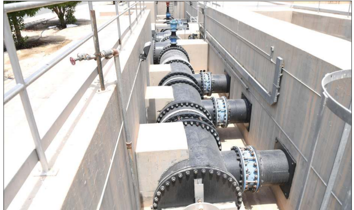
محطة ضخ الجهراء تخدم عدة مناطق وتراعي البيئة
