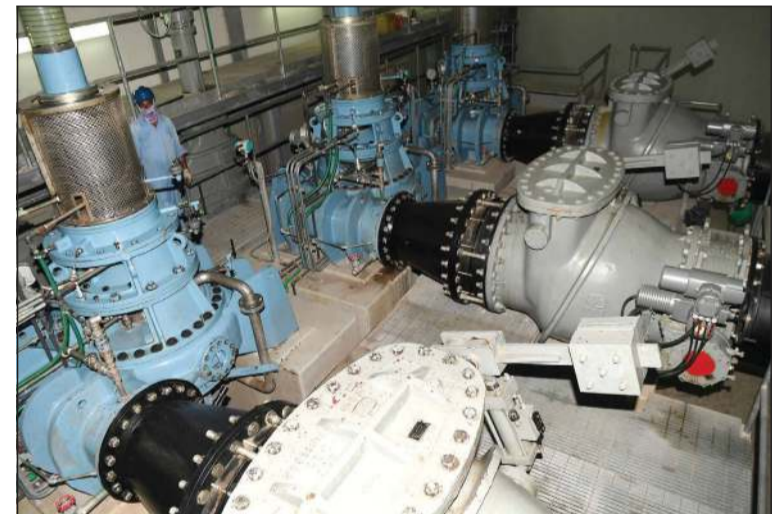
المحطة مزودة بأنظمة حديثة
