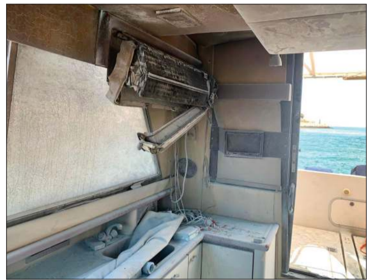
التكييف الذي انطلقت منه شرارة الحريق
