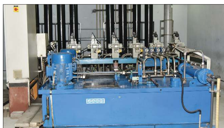
أجهزة المحطة تعمل بكامل كفاءتها
