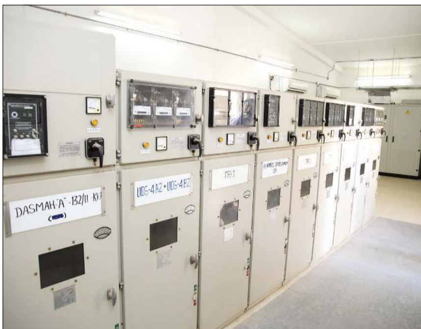
جانبا من محطة المنصورة المغذية للتيار الكهربائي
