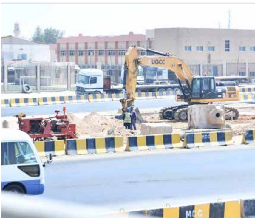
جهود مكثفة من عمال وكليات الشركة المنفذة لإنجاز مشروع الدائري 6,5 في الوقت المناسب
