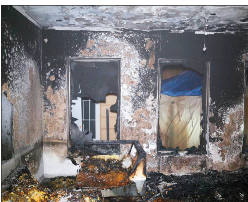
آثار الحريق بعد إخماده
