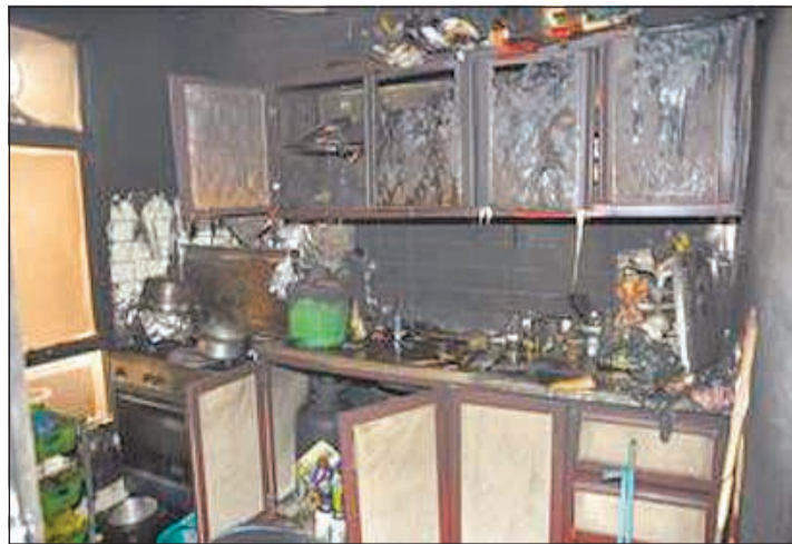
آثار الحريق في مطبخ الشقة
