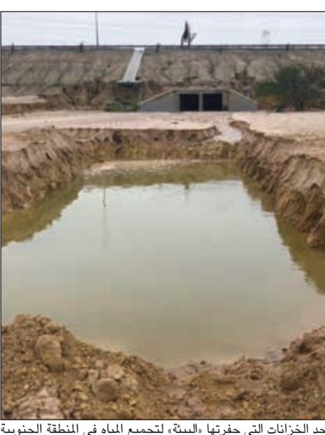
أحد الخزانات التي حفرتها «البيئة» لتجميع مياه في المنطقة الجنوبية
