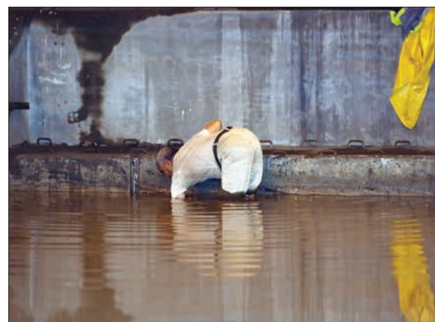
محاولة لفتح احد المناهيل المسدودة لتصريف المياه
