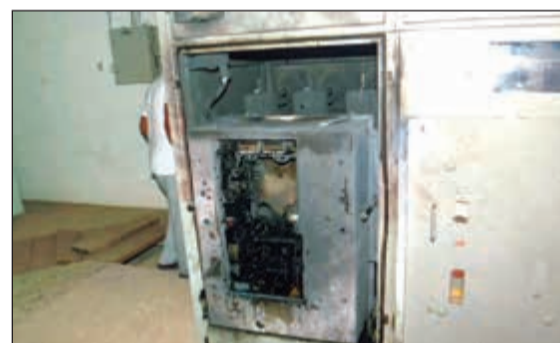
محول الكهرباء المحترق
