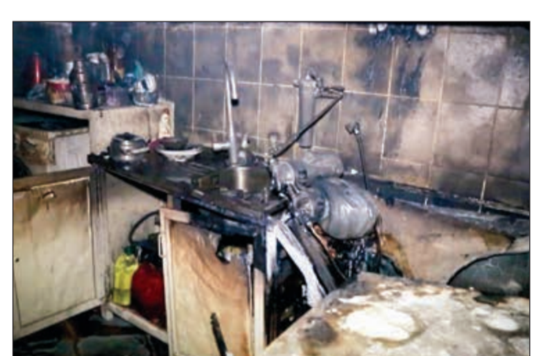
الحريق تسبب في تلفيات بليغة داخل المطبخ
