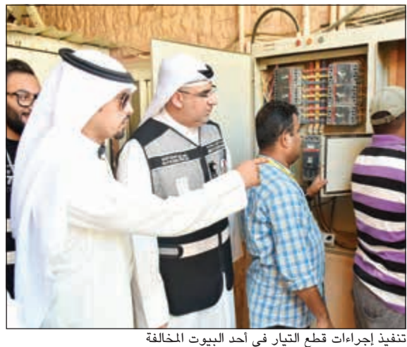
تنفيذ إجراءات قطع التيار عن أحد البيوت المخالفة
