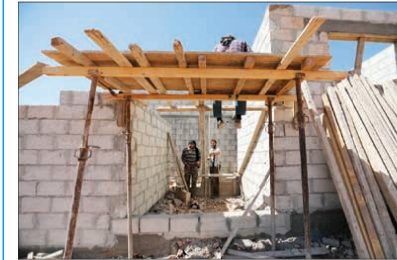
عناصر من جيش الإسلام يقومون ببناء في بلدة سوسيان بريف حلب (رويترز)
