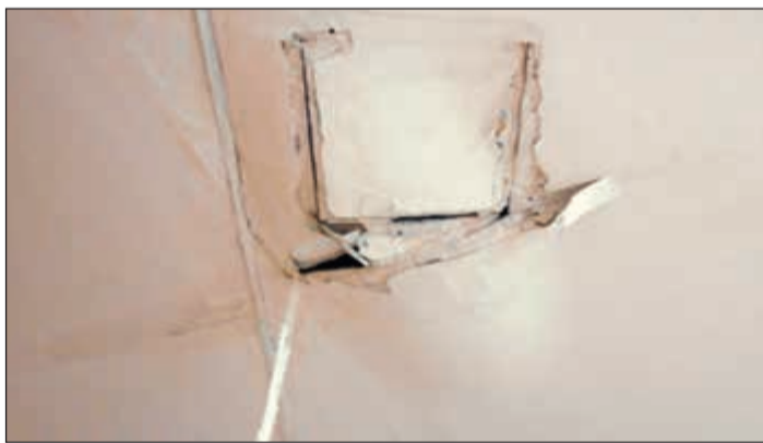
التشقق في أسقف البني وعند فتحات التهوية
