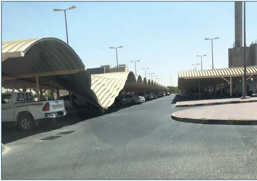
سقوط إحدى المظلات في مواقف بلدية الجهراء
