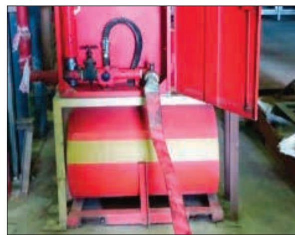
أنظمة مكافحة الحريق في المحطة
