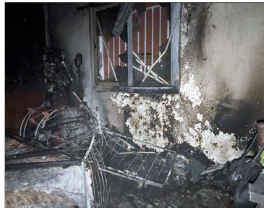
الحريق تسبب في تلفيات جسيمة داخل الشقة
