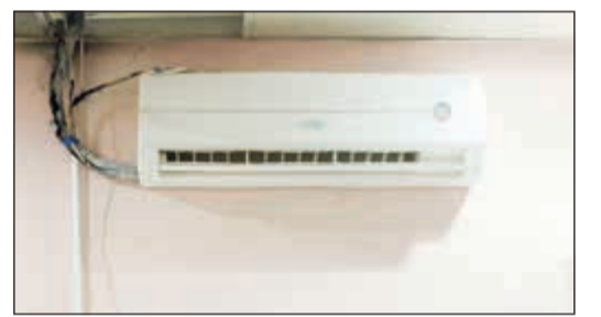
آثار الحريق على وحدة التكييف
