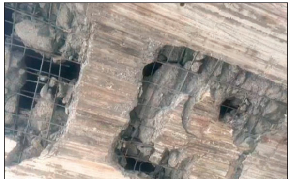
صورة لجزء الجسر الذي تعرض للاصطدام
