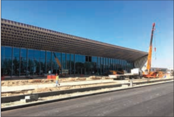
جانب من أعمال مشروع المطار المساند (تي 4) المتوقع الانتهاء منه في الربع الثاني من 2018
