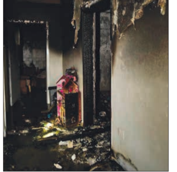
.. وأجزاء أخرى من المنزل بعد إطفاء الحريق
