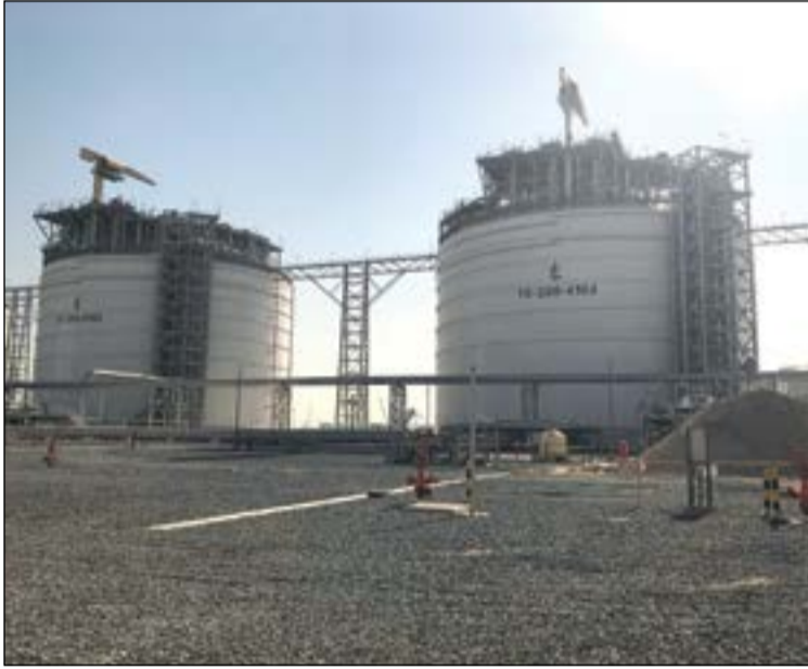
لقطة لأحد الخزانات الجديدة في حظيرة الخزانات الشمالية في مصفاة ميناء الأحمدي
