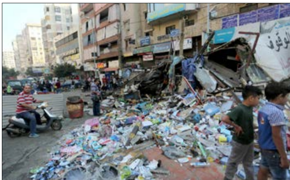
آثار إزالة المخالقات في حي السلم في الضاحية الجنوبية لبيروت (محمود الطويل)
