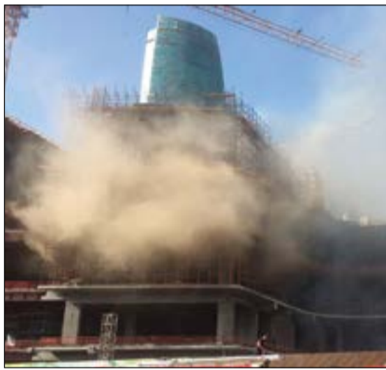
الحريق في مبنى قيد الإنشاء بمنطقة شرق
