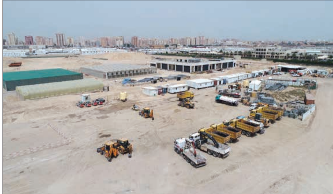
أعمال المشروع لم تتأثر بالحريق
