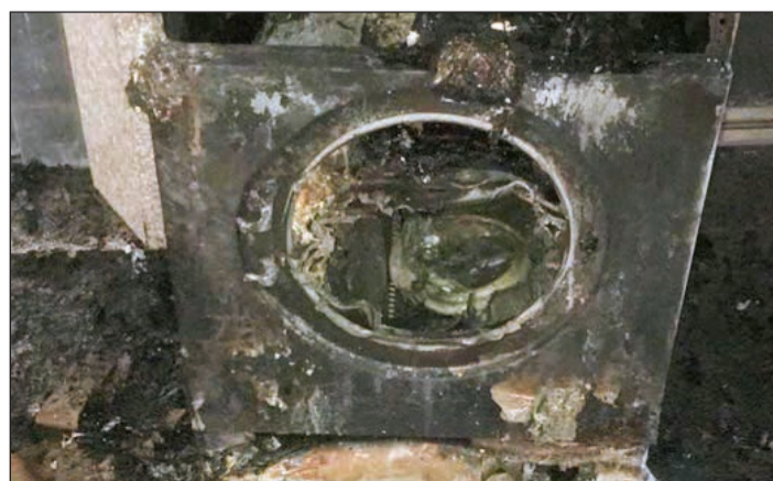
أدوات كهربائية تعرضت للضرر نتيجة الحريق
