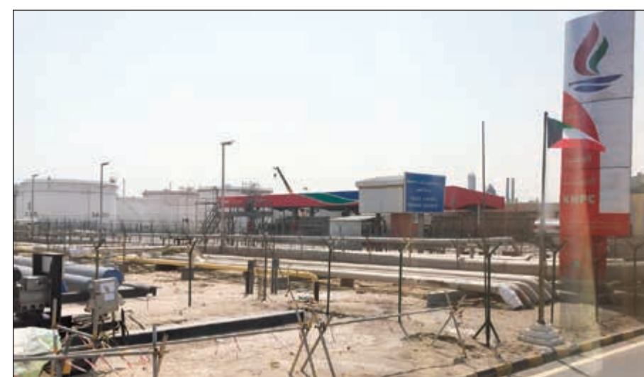
تركيب أجهزة رصد دائمة للغاز وكاميرات فيديو للمراقبة في منشآت النفط
