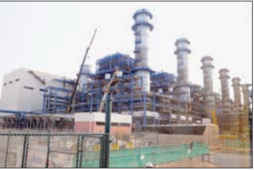
محطة الصببة الكهربائية
