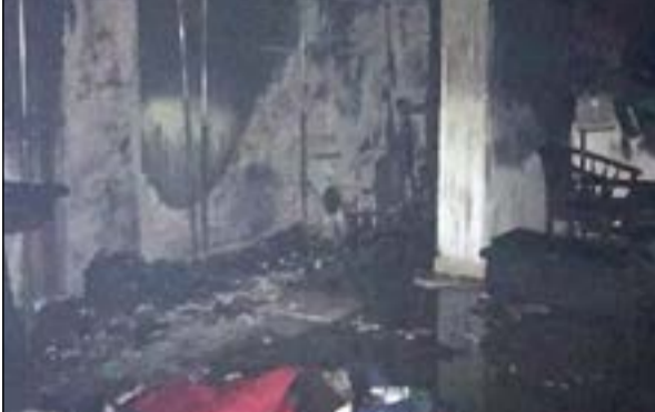
الحريق خلف تلفيات جسيمة في المنزل
