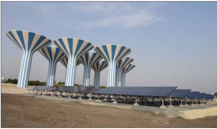
الخلايا الضوئية التي تم تركيبها لإنتاج الطاقة
