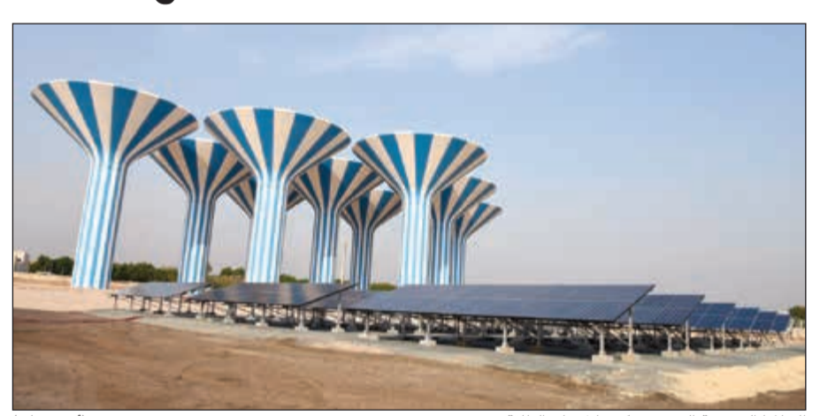
الخلايا الضوئية التي تم تركيبها لإنتاج الطاقة (أحمد علي)
