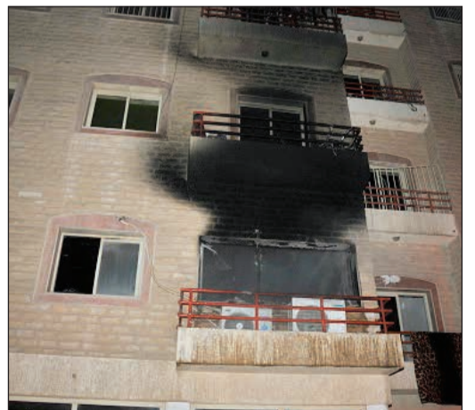
آثار الحريق تبدو واضحة على واجهة البناية
