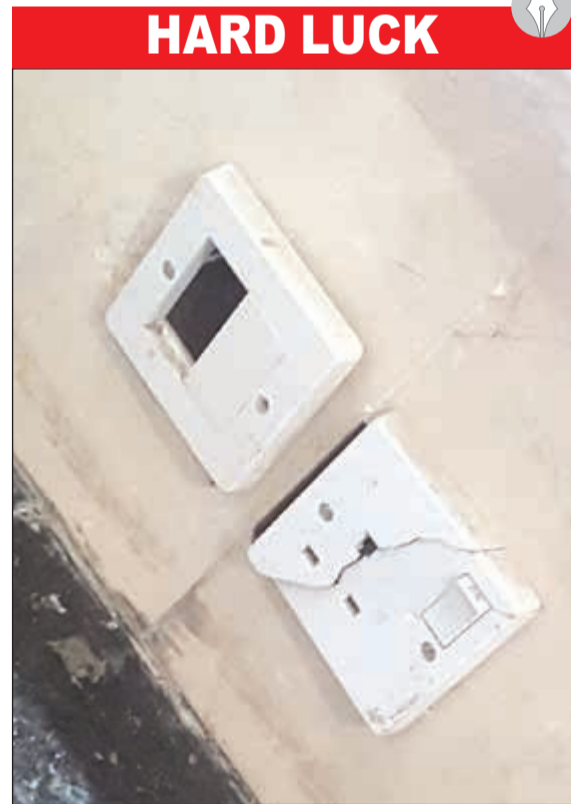
لا تزال منشأة مركز اتحاد كرة اليد تتطلب الكثير من اعمال الصيانة وليس عملية الطلاء الخارجي والداخلي، فالتوصيات الكهربائية مهمة في مركز حيوي رياضي.
