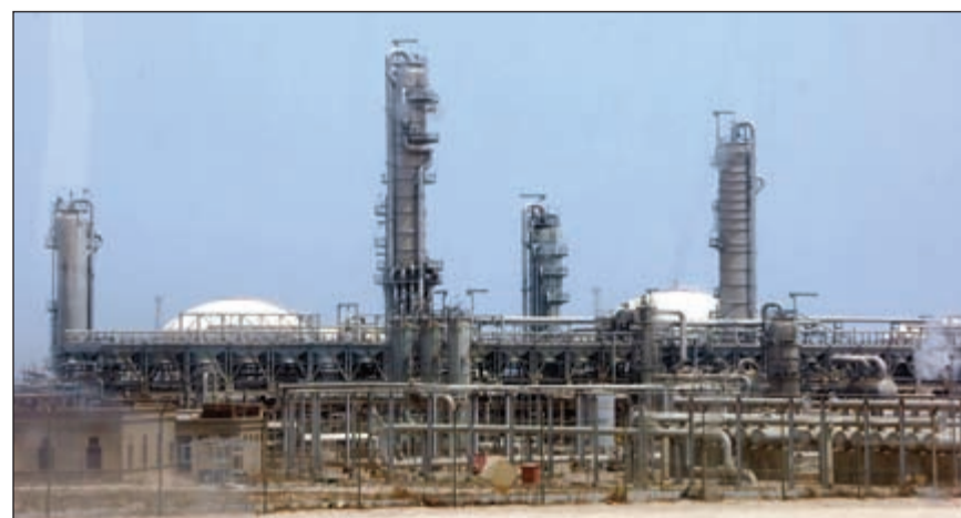
محطة الشعيبة الجنوبية لتوليد الطاقة
