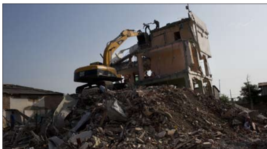
جانب من الخسائر التي لحقت بمباني إحدى المدن في الإكوادور جراء الزلزال (أ.ب)
