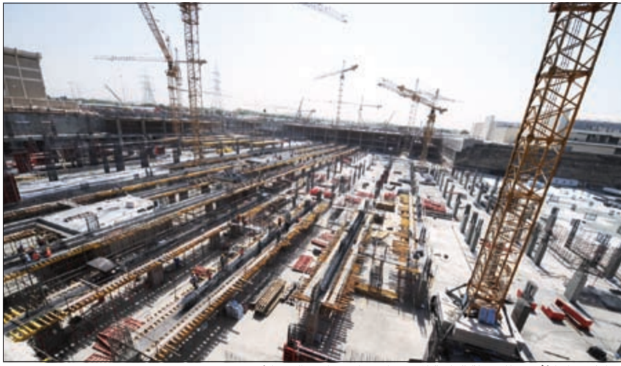
عمليات بناء الأبنية للمرحلة الرابعة المتوقع الانتهاء منها في الربع الأخير من 2017
