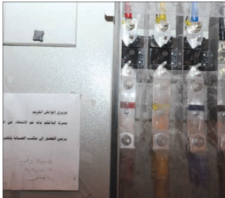
سرقه الكهرباء من محول المنزل بطريقة خطيرة وأسلاك عارية
