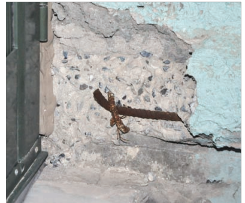
أسياخ صمته بمواقع خطيرة رغم حداثة البناء
